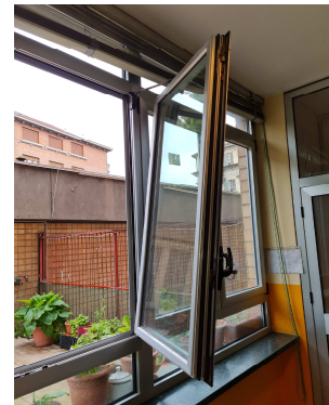
(foto 3) SITUAZIONE DI PERICOLO finestra anta-ribalta aperta in "falsa manovra" sia ad anta che a ribalta
